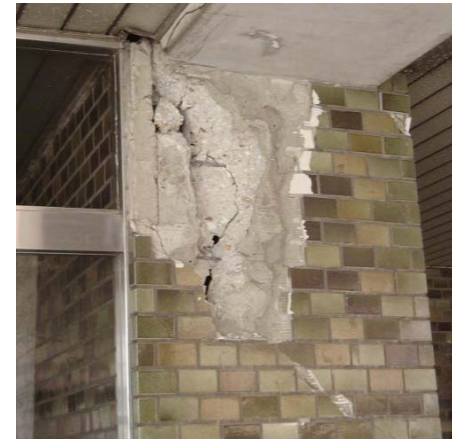
柱の損傷状況 (仙台市富沢駅周辺)
