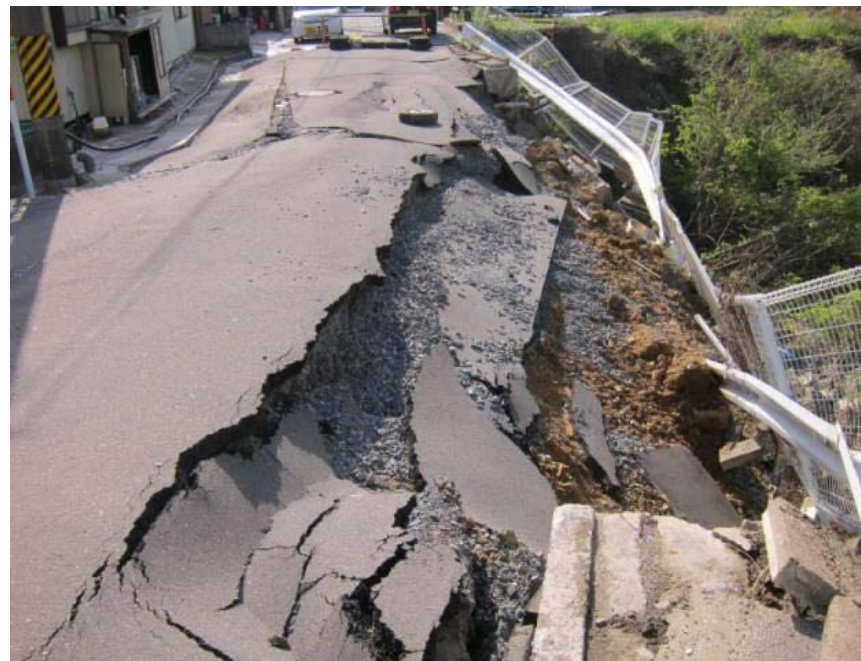
道路被害の状況(宮城県牡鹿郡女川町)
