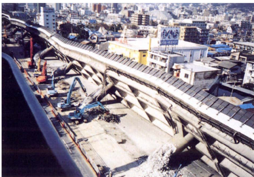
阪神高速道路の倒壊(神戸市深江本町)
