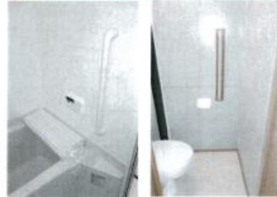
浴室やトイレの手すり設置の状況
