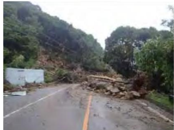
写真 平成23年紀伊半島大水害時の鵜殿熊野線の法面崩壊（三重県紀宝町） （出典：三重県ホームページ「紀伊半島大水害の記録」）
