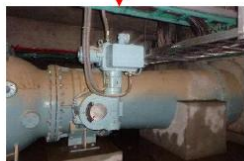
被災したポンプ吐出弁電動機
