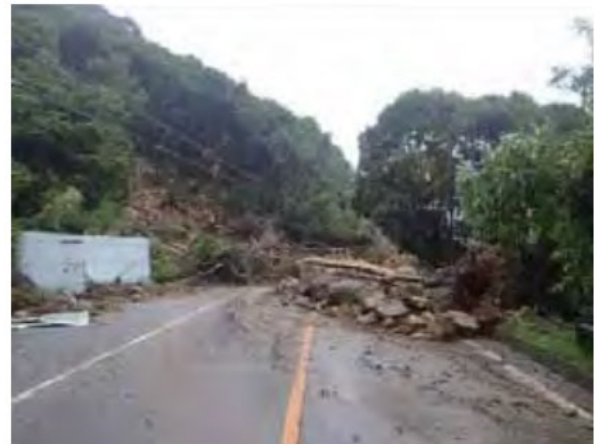
写真 平成23年紀伊半島大水害時の鵜殿熊野線の法面崩壊（三重県紀宝町）
