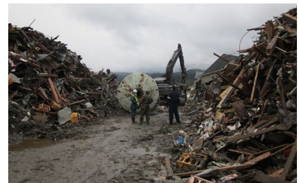
東日本大震災の津波による被害 (岩手県陸前高田市)
