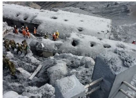
噴石で穴の開いた山小屋の屋根
