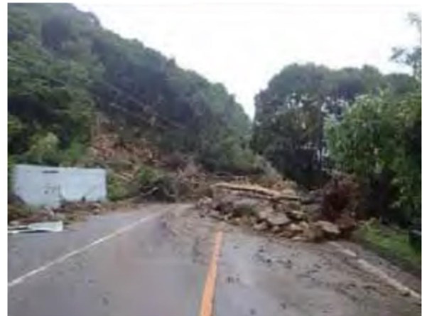
写真 平成23年紀伊半島大水害時の鵜殿熊野線の法面崩壊（三重県紀宝町） (出典：三重県ホームページ「紀伊半島大水害の記録」)
