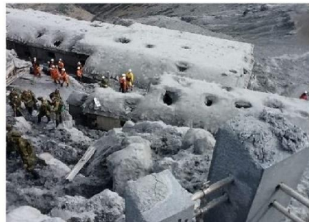
噴石で穴の開いた山小屋の屋根
