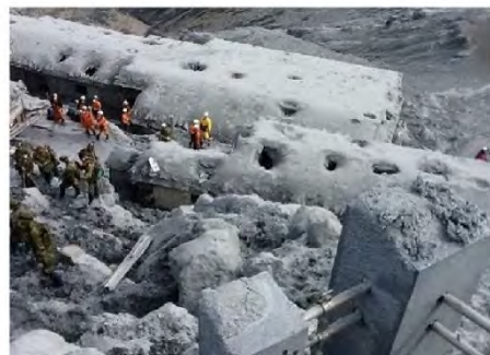
噴石で穴の開いた山小屋の屋根
