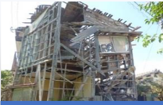
Dランク：損傷が著しく倒壊などの危険がある。
