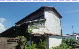
Cランク：使用するには多額の修繕費がかかる。
