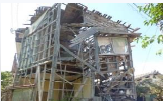
Dランク：損傷が著しく倒壊などの危険がある。
