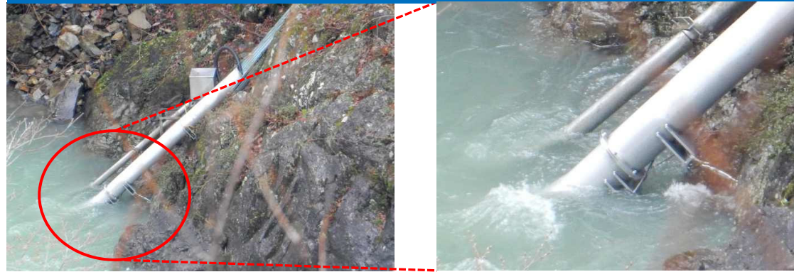
自動水質計の設置状況 六段橋(牧尾ダム放流口)
