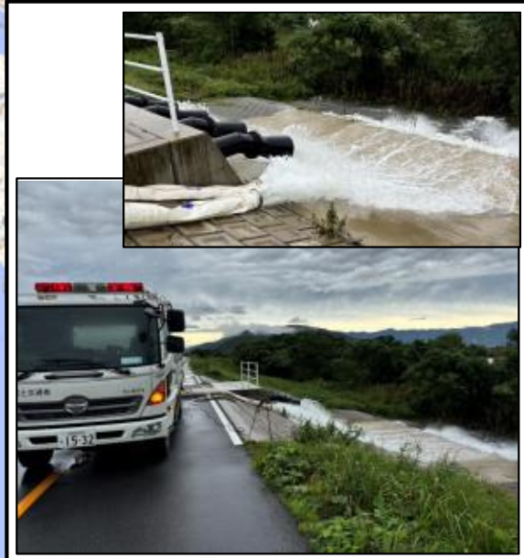
排水ポンプ車稼働状況 (岐阜県養老町)
