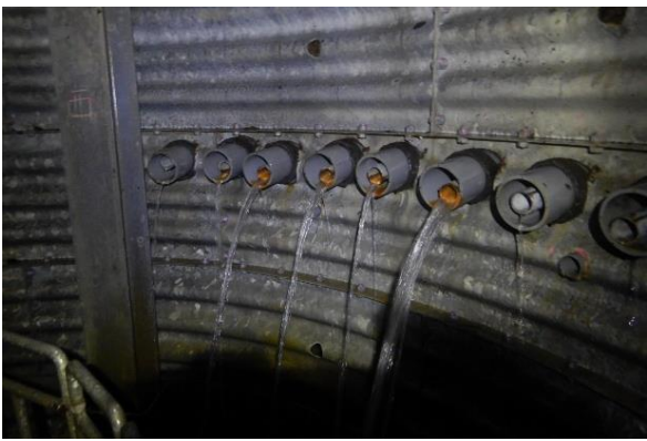
集水井の排水状況
