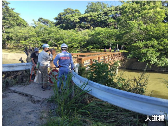
人道橋 ①公園と牛川町松下地区を結ぶ人道橋の被災について、助言
