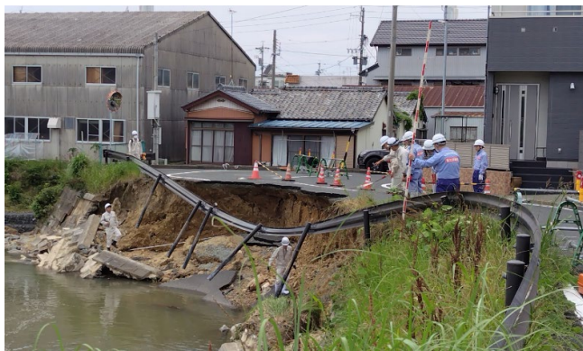
②山中川の被災状況調査
