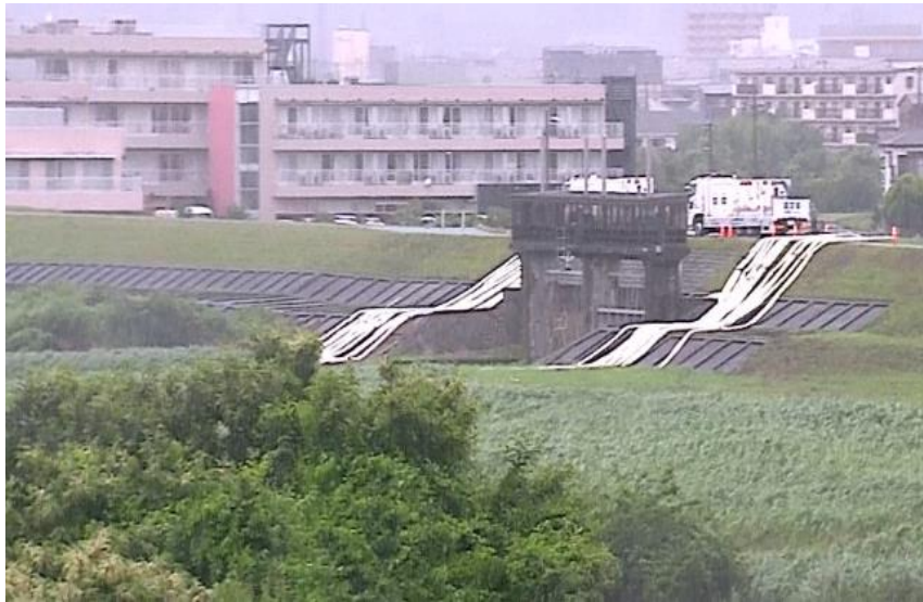
○長伏樋管排水ポンプ車活動状況
