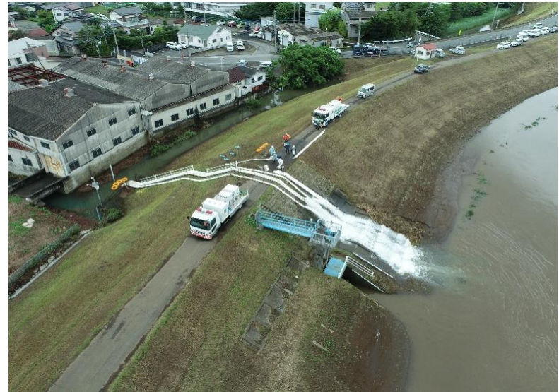
○中郷第一樋管排水ポンプ車活動状況
