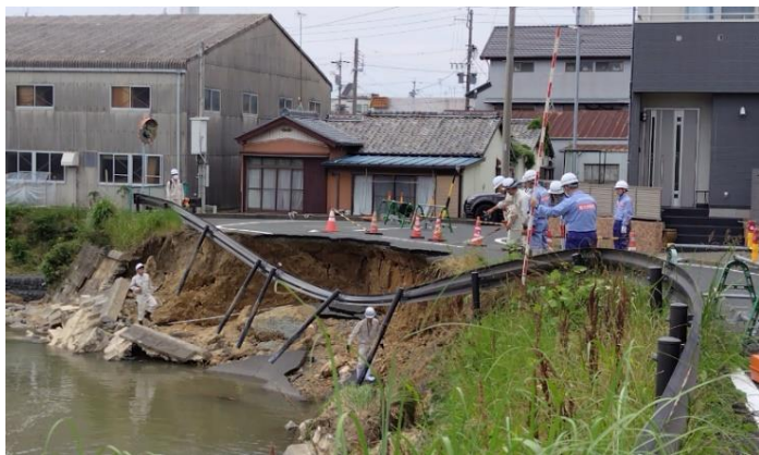
山中川の被災状況調査
