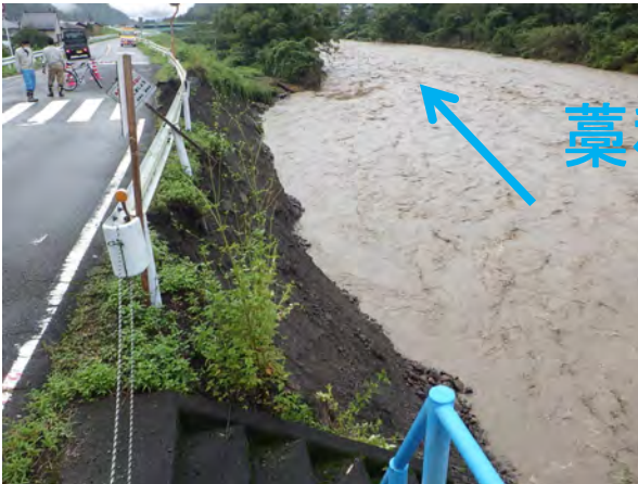
被災状況(下流側)
