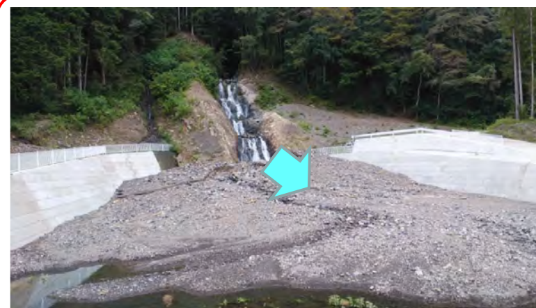
土石流発生後 (R4.9.28撮影)
