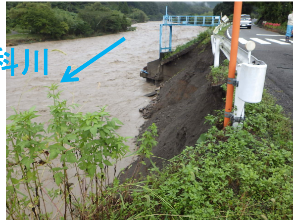
被災状況(上流側)
