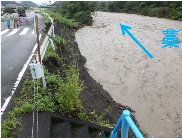
被災状況(下流側)
