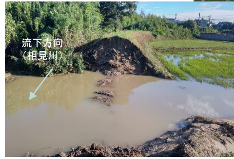
写真① 破堤箇所(近景) 9/24 7:30
