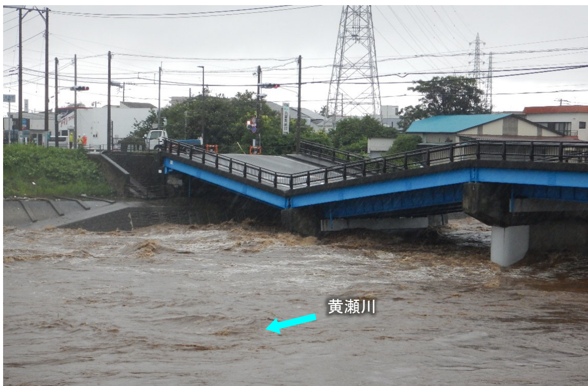
黄瀬川大橋橋脚、橋梁の損傷
