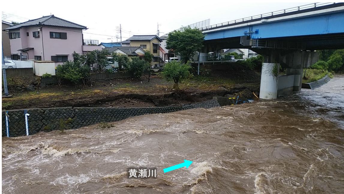
損壊した黄瀬川本宿の護岸
