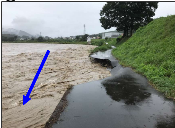
8月15日10:00 管理用通路の欠損状況
