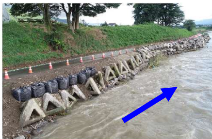
欠損箇所上下流での河岸侵食を防ぐため補強工事を行いました。
