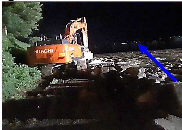
8月15日21:00 応急復旧状況(欠損箇所)
