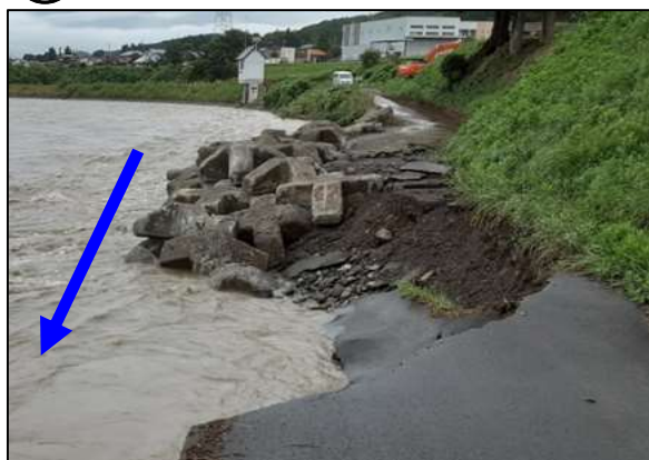
8月16日6:00 応急復旧状況(欠損箇所)
