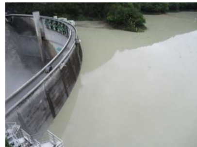
洪水後小渋ダム 貯水池状況 (8月16日 8時)
