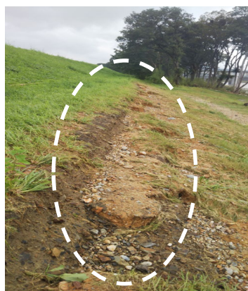
木曽川左岸67.8k 堤防川表の法崩れ状況
