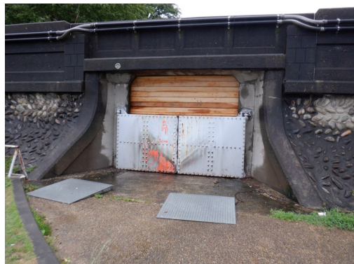
起陸閘の閉鎖状況
