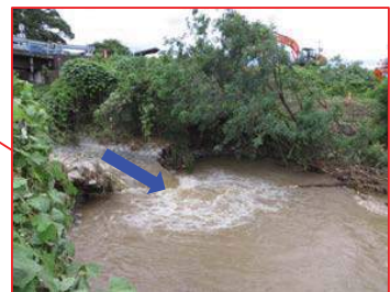
●喬木村【壬生沢川合流点】 (護岸一部流出)
