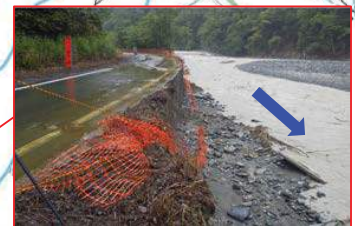
●中川村【小渋川右岸2.9kp】 (河岸洗掘)
