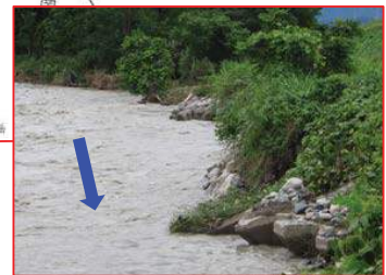
●豊丘村【壬生沢川合流点上流】 (護岸一部流出)
