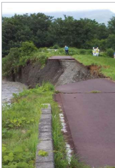
7月1日8:00 堤防の欠損状況の確認
