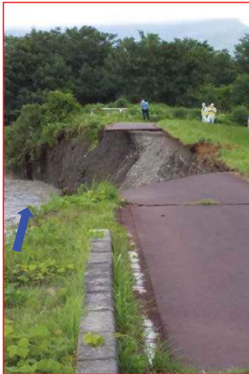
●伊那市【三峰川右岸4.6kp付近】 (堤防の欠損)
