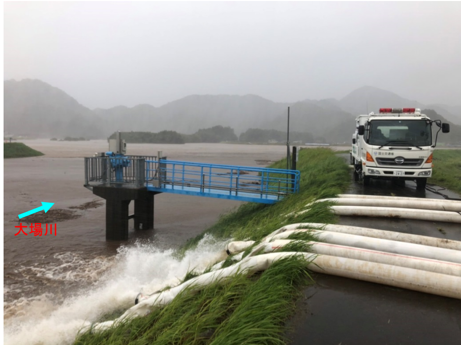
御園地区における稼働状況
