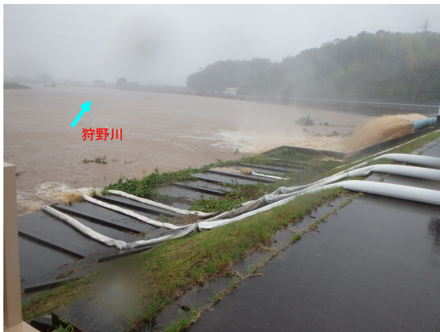
宗光寺川における稼働状況
