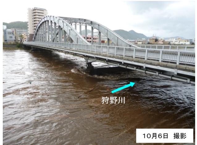
台風第18号による出水状況
