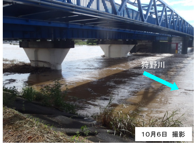
台風第18号による出水状況
