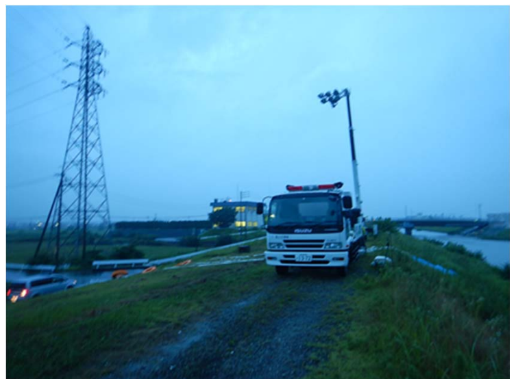
7月6日照明車及び排水ポンプ車設置状況
