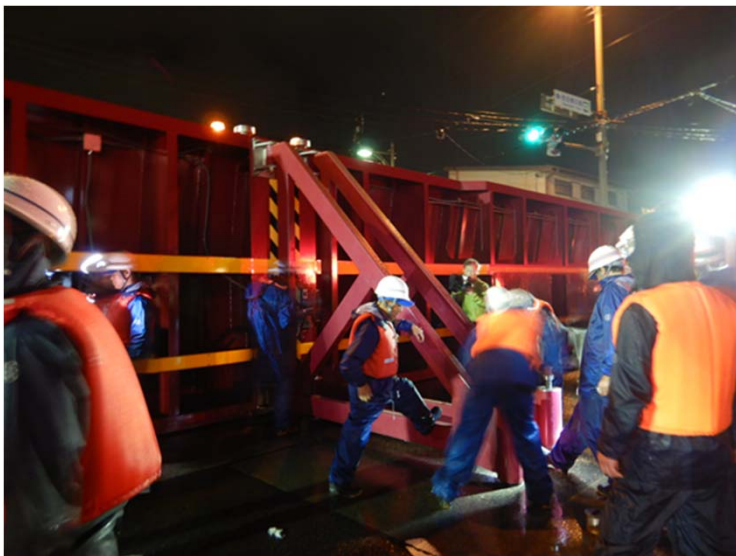
7月8日0時30分頃 大宮陸閘の閉鎖状況
