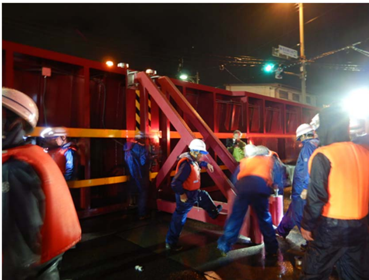
7月8日0時30分頃 大宮陸閘の閉鎖状況
