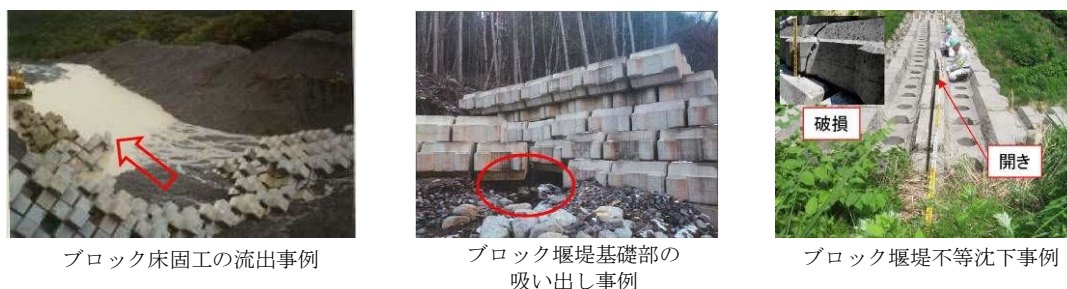
図 14-1-1 ブロック堰堤破損状況（事例）
