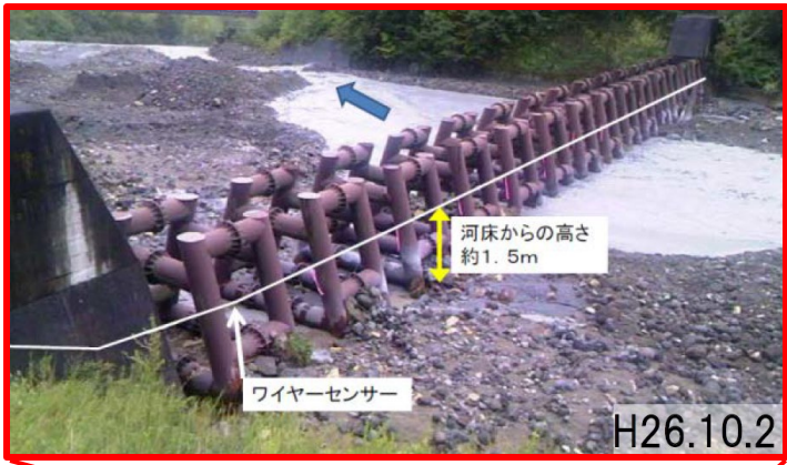
柳ヶ瀬3号堰堤(長野県)へのワイヤーセンサー(国交省)設置状況
