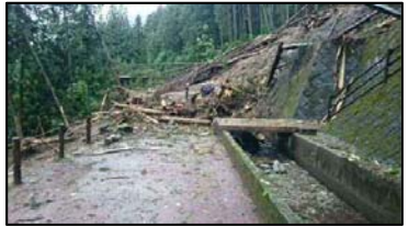
③萩原中央用水(下呂市)の被災状況
