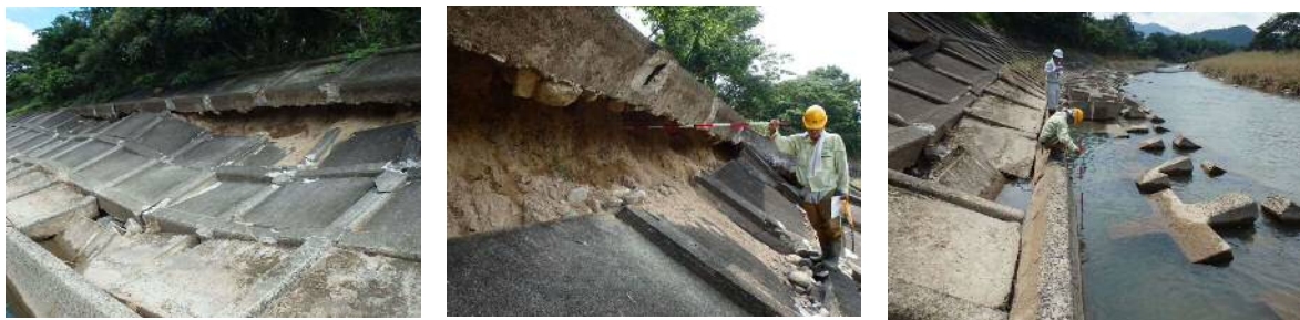
洗掘、吸い出しによる護岸の被災事例
