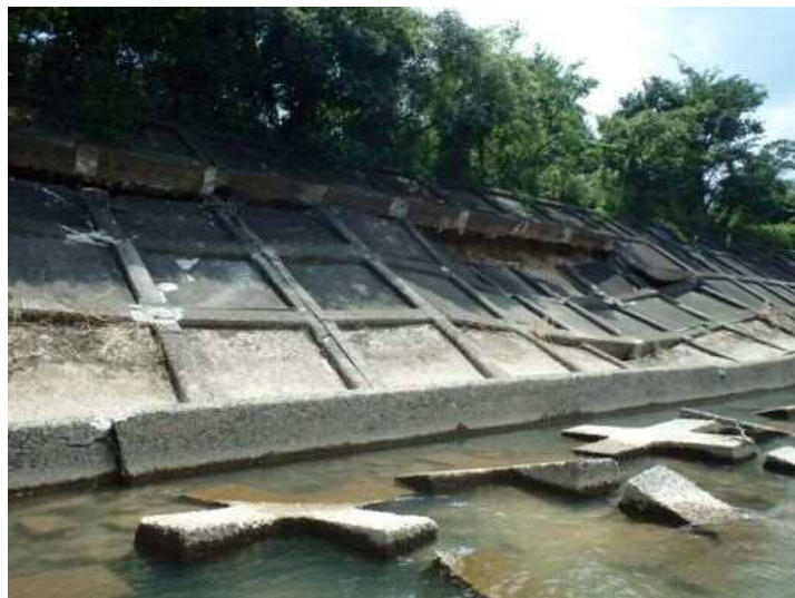
吸い出しによる護岸の被災例
