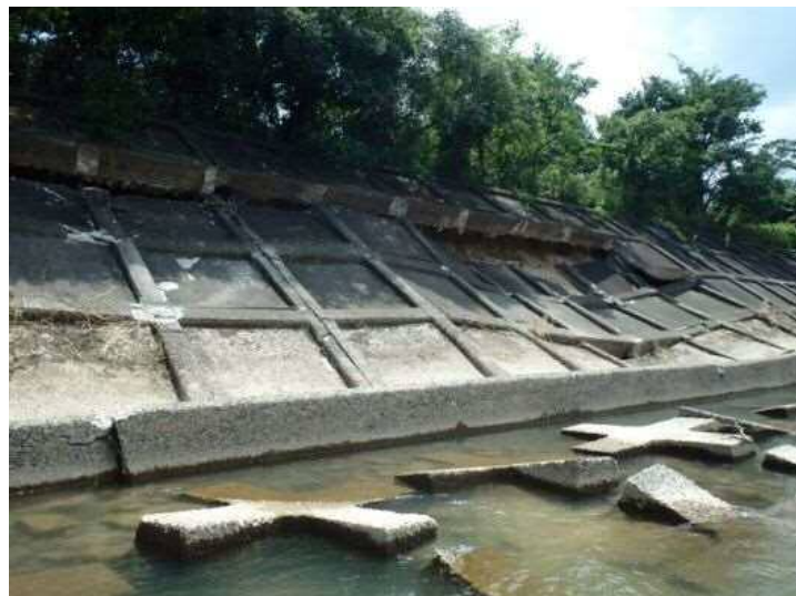
吸い出しによる護岸の被災例
