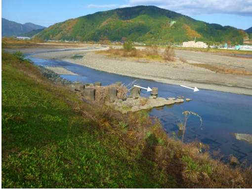
設置目的：流速減少、洗掘防止 種類：透過水制 材料：ブロック（ポスト） 向き：直角
