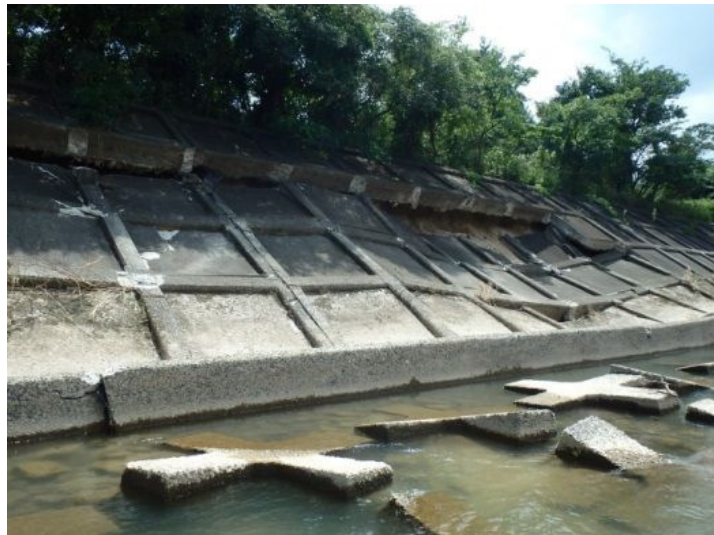
吸い出しによる護岸の被災例
