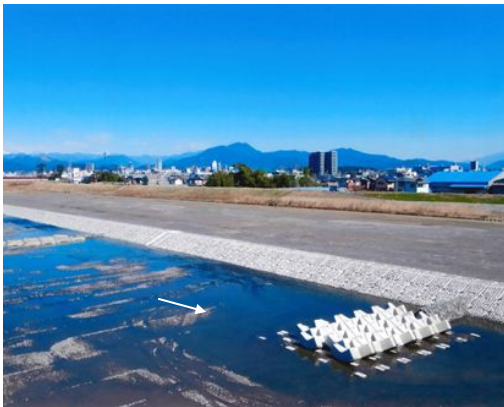
設置目的：流速減少、洗掘防止 種類：不透過水制 材料：ブロック 向き：直角
