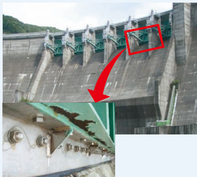
非常用放流設備（クレストゲート）の老朽化による腐食状況の事例。このままでは腐食が進行し、構造物の機能に支障が生じる可能性があるため、早期に措置をする事が望まれます。
