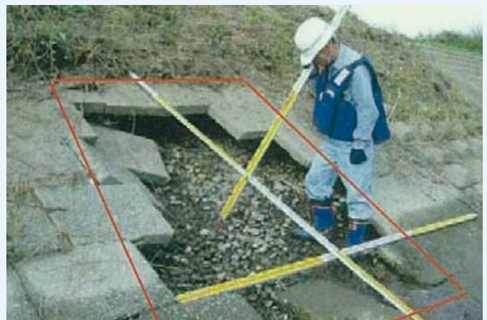
護岸が部分的に流出し、護岸背面の土砂が吸い出され、空洞化が進んでいる様子です。護岸の機能が失われており、適切な措置を要します。
