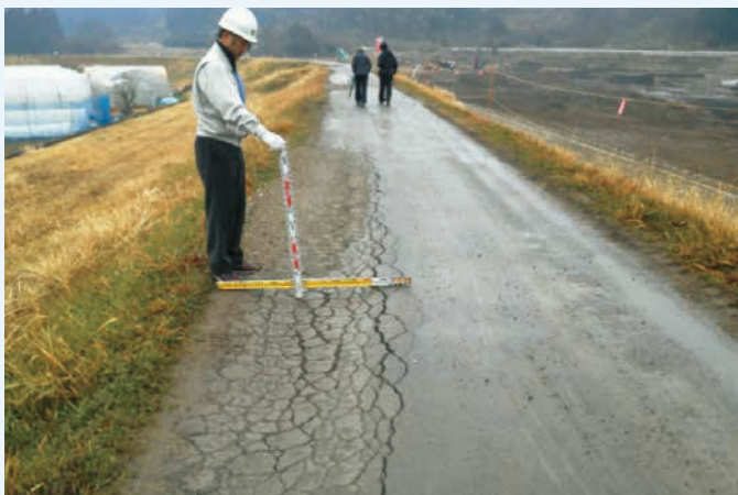
天端の法肩部は強度が弱く、陥没や沈下などの不陸を生じることがあり、雨水集中の原因となります。この例では、変状が進行する可能性があるため、経過を監視していく必要があります。
