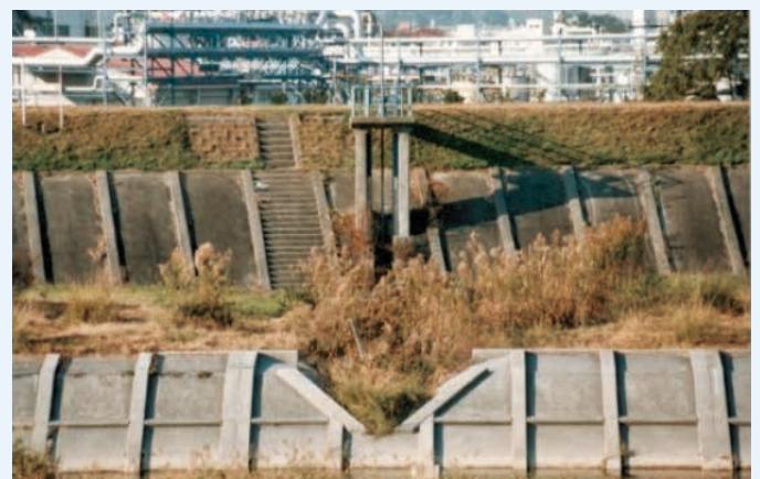
水路に土砂が堆積するなど維持管理が不十分な樋門
