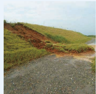
雨水の堤防への浸透に起因して法崩れが発生した様子。堤防機能に支障が生じており、直ちに措置を要します。
