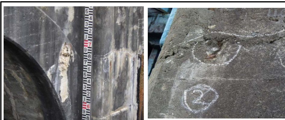
堰柱 剥離・鉄筋露出・遊離石灰
