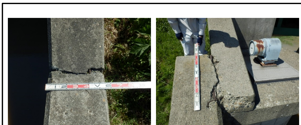
翼壁 破損・鉄筋露出
