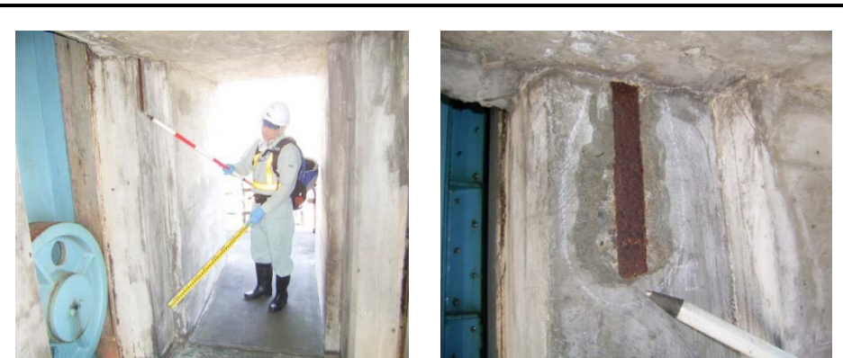
門柱 剥離および鉄筋露出
