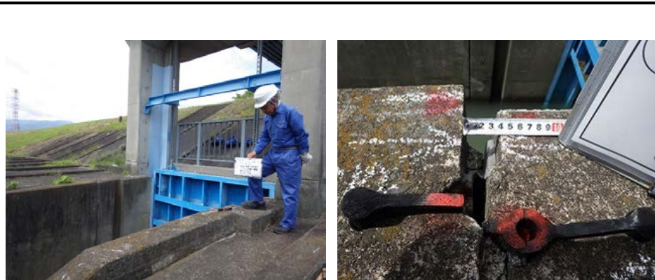
翼壁目地の開き(止水板露出部の欠損)
