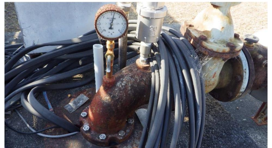
地下水汲み上げ状況 (工水受水事業所 地下水配管、圧力計)
