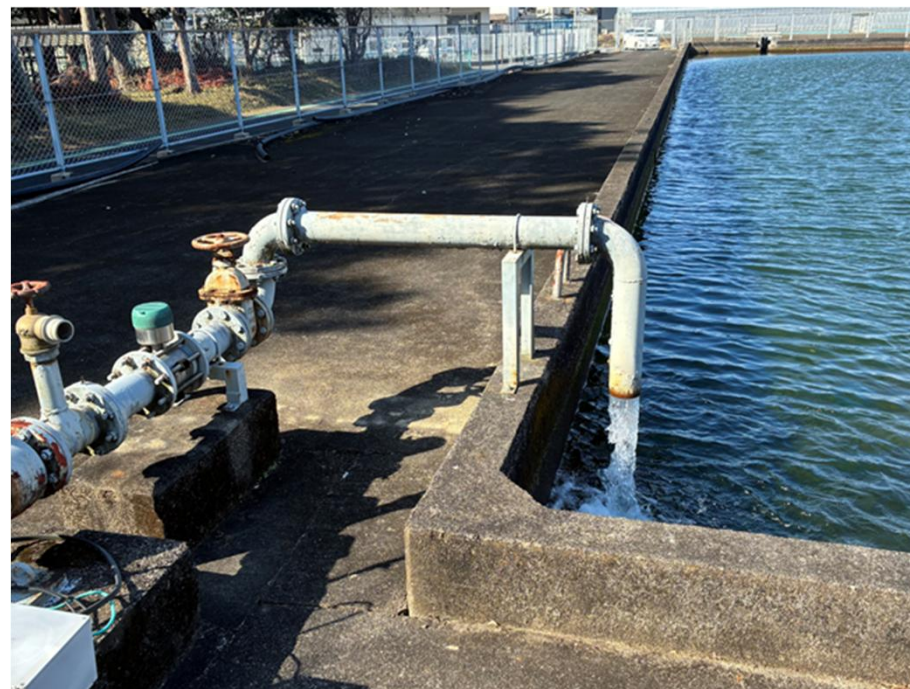
緊急水源である井戸ポンプによる 地下水利用
