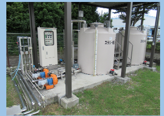
活性炭注入施設
