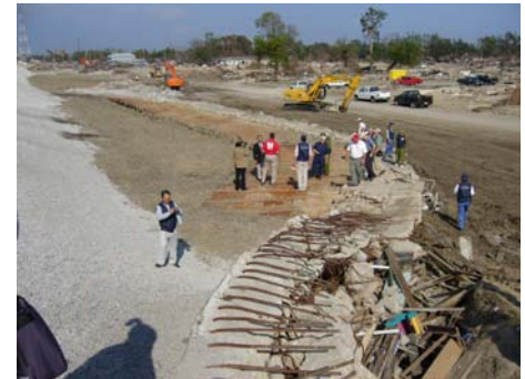
工業運河の破堤箇所
