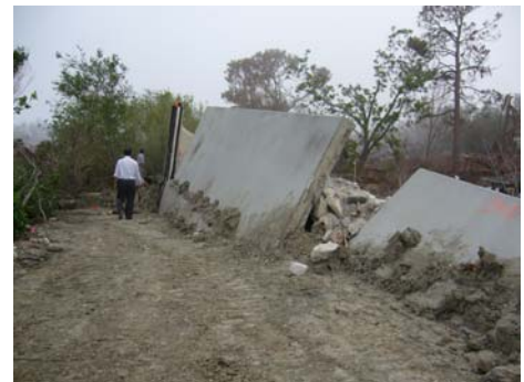
ロンドン通り運河の破堤箇所(下流)
