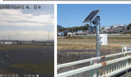
CCTVカメラ映像
