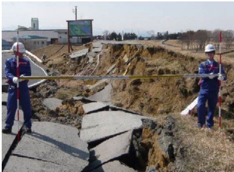
図 7-2 堤防の崩落箇所の調査(東日本大震災時)
