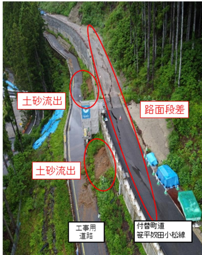
付替町道笹平奴田小松線の被災状況
