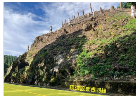
落石危険箇所
