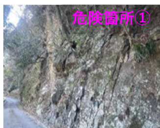
岩盤崩落の危険
