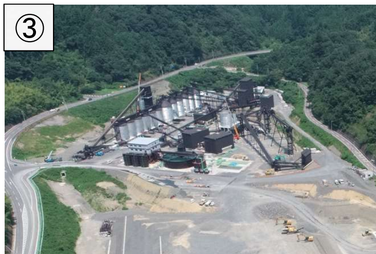
骨材製造設備
