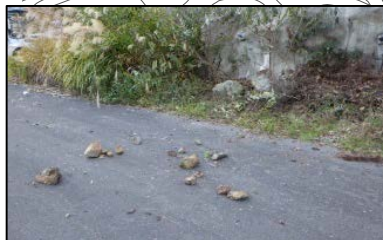
左岸側法面の落石状況
