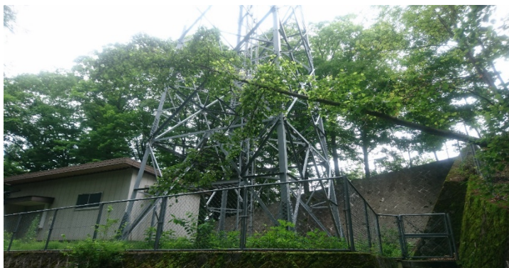
倒木により中継所の鉄塔に寄り掛かっている状況
