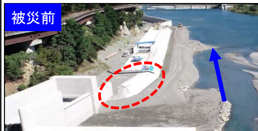
導水路護岸の被災
