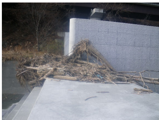
流木堆積状況
