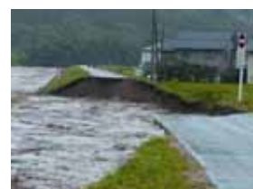
H18.7 災害 堤防決壊 (箕輪町松島地区)
