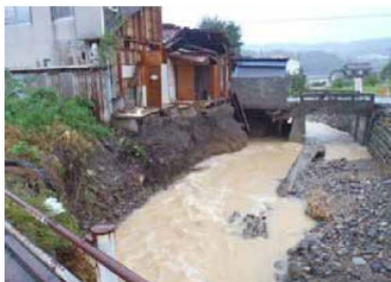
御嵩町御嵩地区氾濫状況
