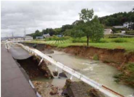
可児市矢戸地区被災状況
