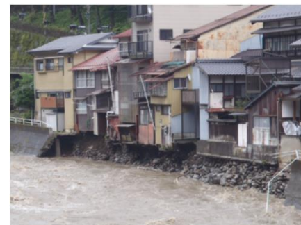
木曾町福島地区(護岸・家屋基礎流出)
