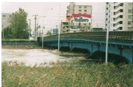
平成3年9月洪水 橋桁を洗われそうな一色大橋
