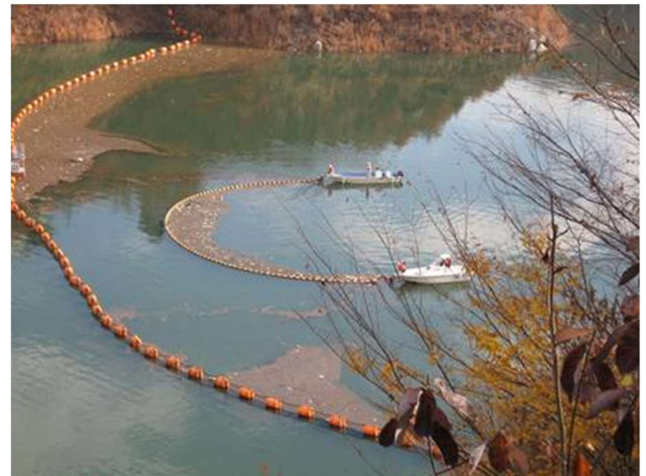
流木の回収状況
