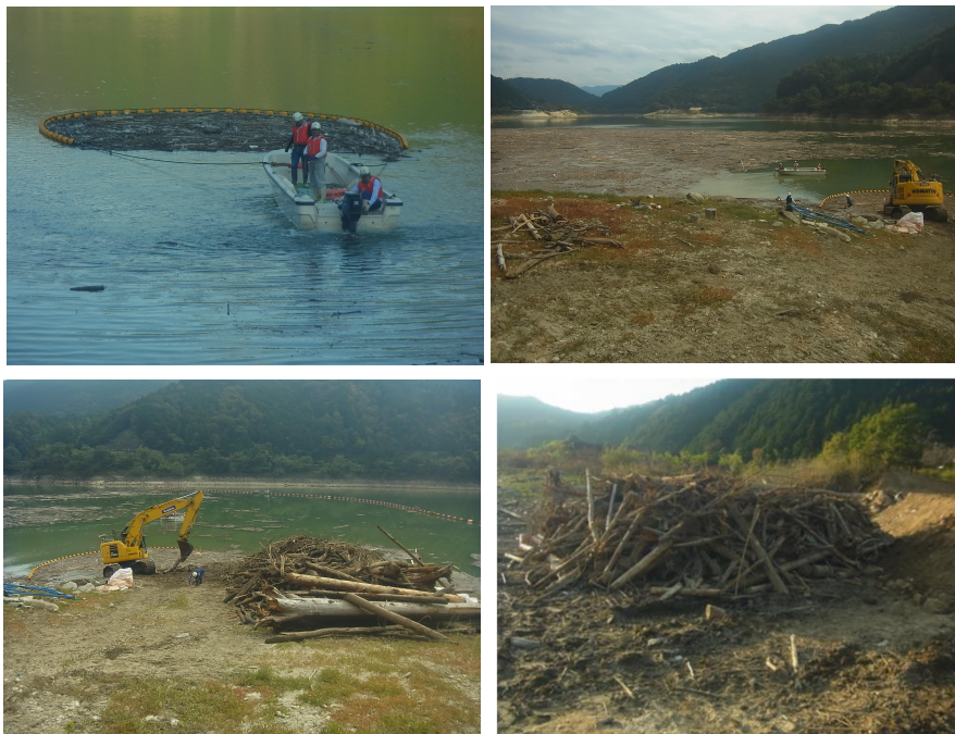
流木等の回収状況
