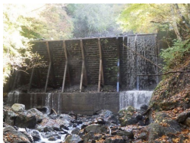
砂防堰堤(安倍沢)
